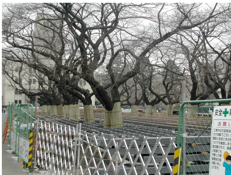
大岡山本館前。桜並木の延命のための工事が進んでいます。
